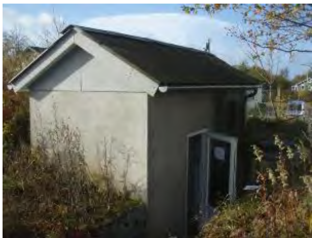
Store Lihme Vandværk
